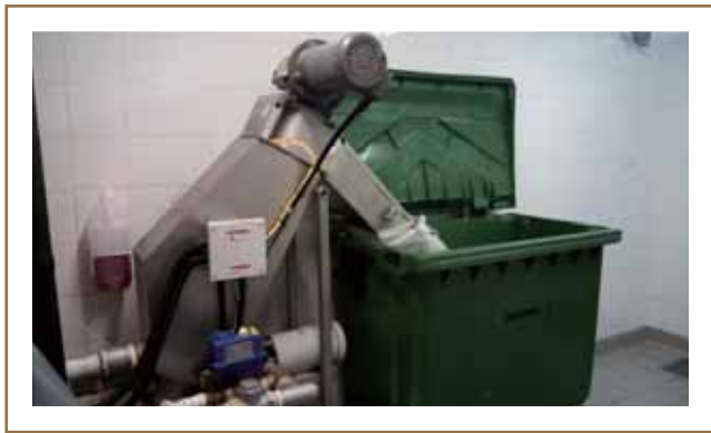
在「澳門銀河™」第二期員工餐廳安裝了全新的Hobart Pulper廚餘處理機，將廚餘壓縮脫水，使廚餘體積大幅減少八成
